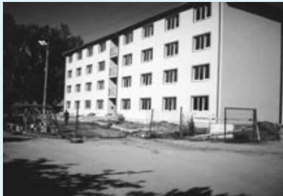
Na Kolónii vyrástla bytovka, v ktorej je 61 bytov určených predovšetkým pre mladé začínajúce rodiny. Prvú nájomnícku sa do nej začnú sťahovať už v decembri. Fotografia dokumentuje stav zo začiatku októbra.
