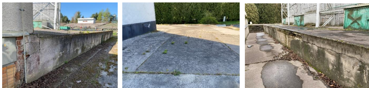
Poškodenie konštrukcie javiska
