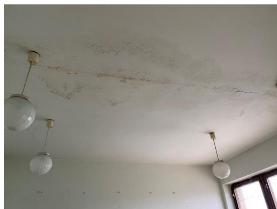
Poškodenie stropných omietok zatečením
